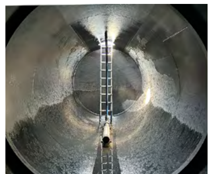
Blick in die 100 m 3 -Zisterne
