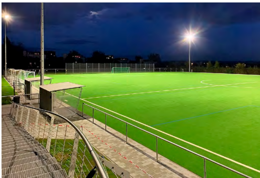
Nachhaltig (III): Die Flutlichtanlage kann für die verschiedenen Nutzungen gedimmt werden.
