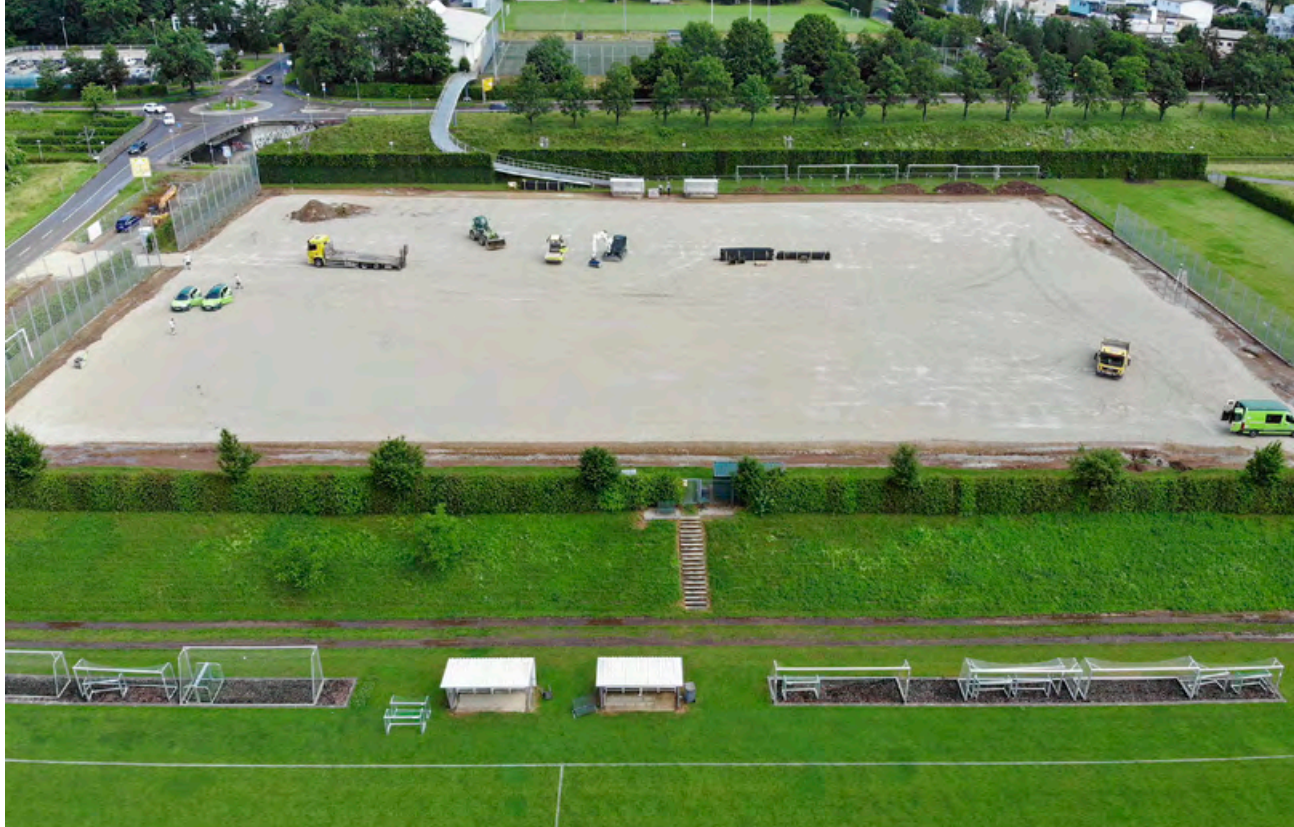
Vorbereitungen zur Sanierung von Dränage und Schichtaufbau, im Hintergrund die Fußgängerbrücke für direkten Zugang vom Sportschulgelände
