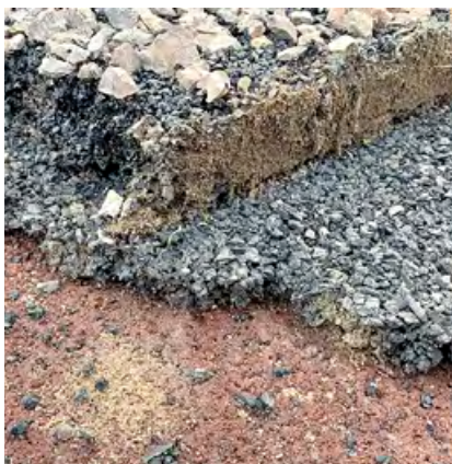
Mehrschichtiger Unterbau aus über 30 Jahren
