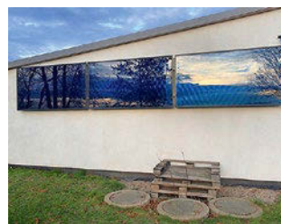
Mit der Solarthermie-Anlage in Verbindung mit Bioöl kann der HC Esslingen seinen Emissionsausstoß deutlich verringern. Foto: Verein
